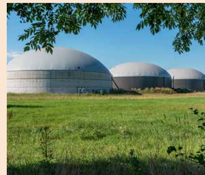
ABBILDUNG 3 ▶ Biogasanlage in der Nähe von Leipzig. (Foto: Urs Moesenfechtel, UFZ)
